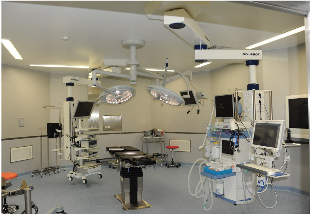
CHU de Bayonne - Bloc opératoire - Bras 4 Mt
